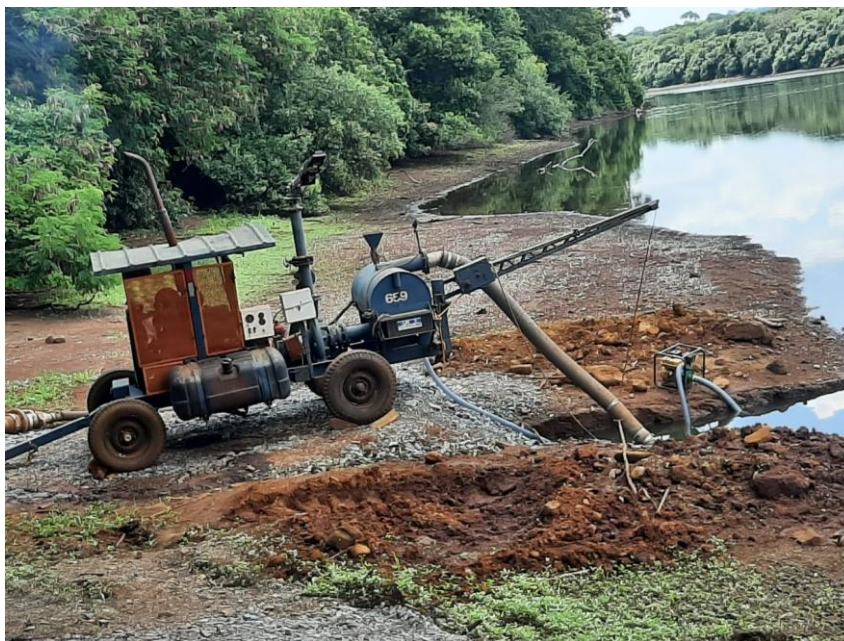
Figura 1 – Motobomba móvel para captação forçada da água reservada
